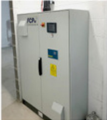
1 Fan Control Panel
